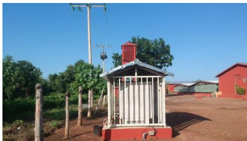
Groupe électrogène + transformateur SBEE sur pylône
